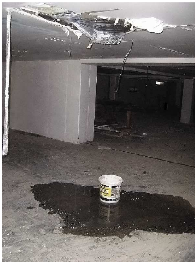
Obr.2: Destrukce sádkartonového podhledu v garážích
